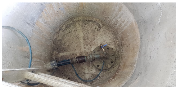
Tørbrønd med installationer.
