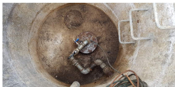
Tørbrønd med installationer.
