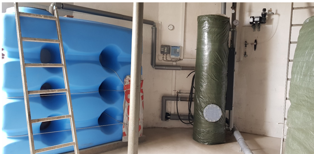
Trykfilter og bundfældningstank til opsamling af returskyllevand er etableret i rummet i højen.
